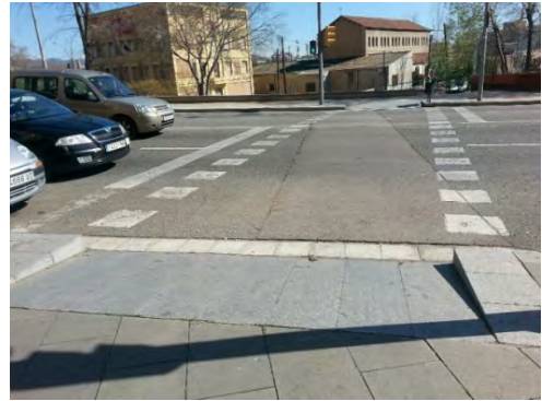
Pas de vianants c. Extremadura
