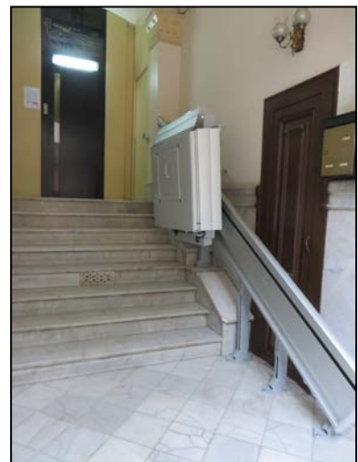
Plataforma remunta-escapes practicable
