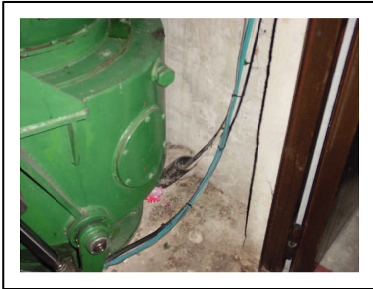
Sortida del conduit amb el tub d'aire comprimit i el cable de senyal.
