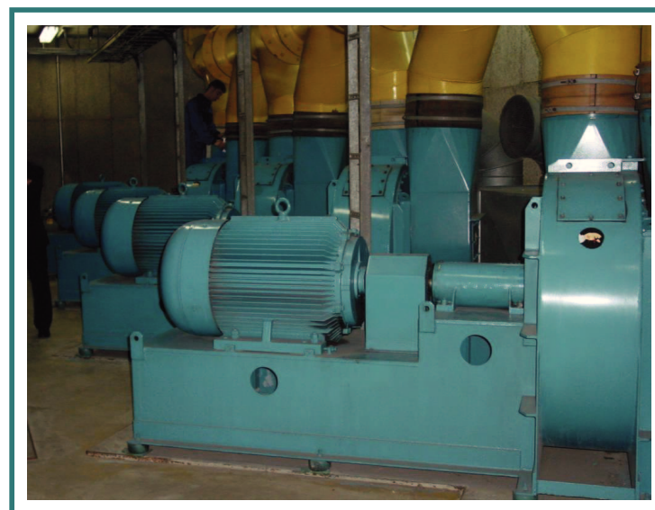
Turboextractors per a la generació de corrent d'aire a la canonada.
