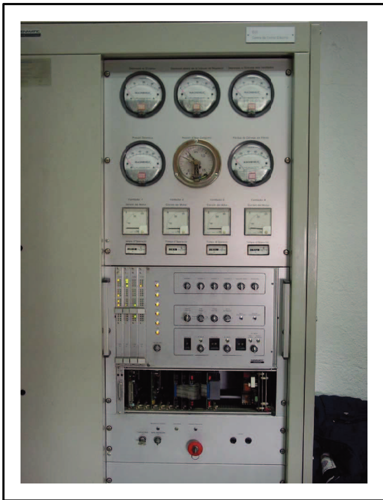
Armari de control del sistema, en la central de recollida.
