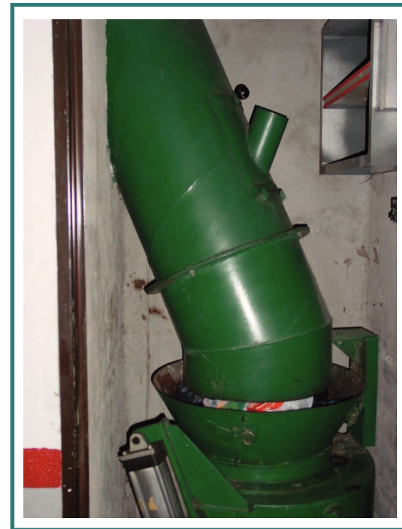
Caiguda del baixant a la vàlvula. S'observa la inclinació respecte la vertical, no superior a 30^\circ .
