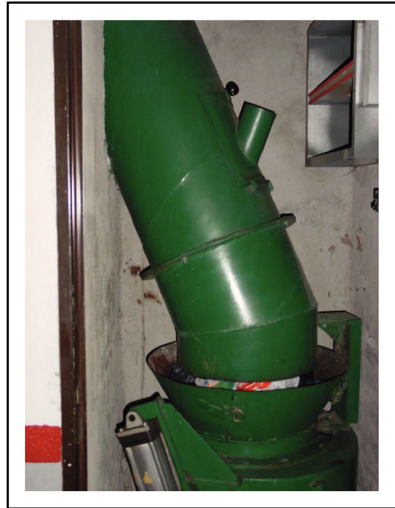
Caiguda del baixant a la vàlvula. S'observa la inclinació respecte la vertical, no superior a 30^\circ .
