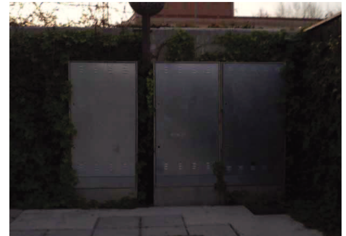
Imatge 1 Quadre Electric al Parc Central de Poblenou
