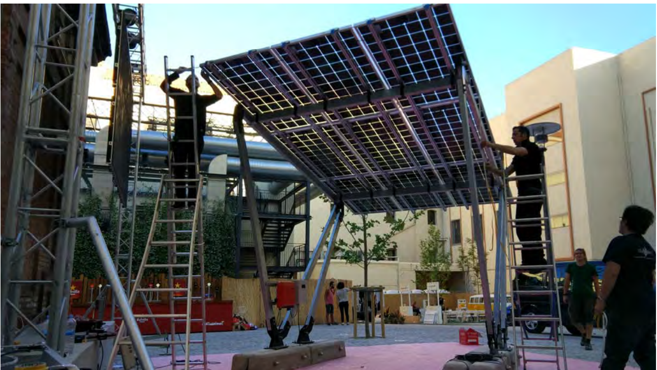
Fig. 10 Pèrgola metàl·lica amb mòduls bifacials. Efecte vidre-vidre.
