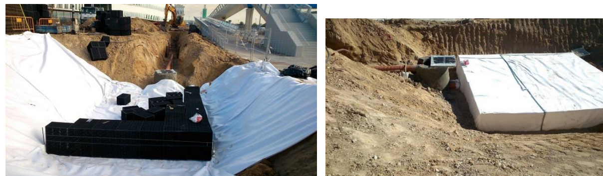
Figura 74: Depósitos de infiltración en la nueva sede del BBVA, en Madrid (Fuente: Ayuntamiento de Madrid).
