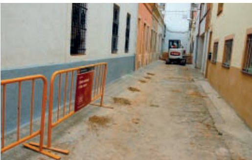
Les obres del passatge Sant Pau van ser les primeres a començar.
