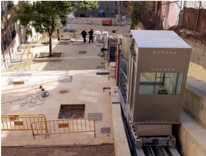
Un dels nous ascensors que s'estan instal·lant al carrer Telègraf, a final de desembre.
