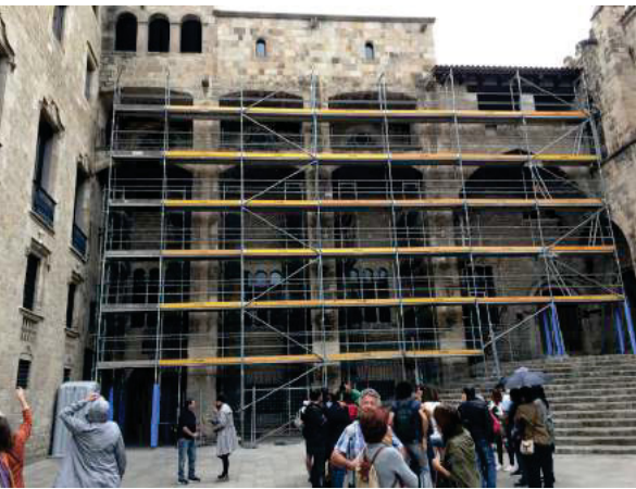
A l'esquerra, panoràmica general de la façana on s'està fent la rehabilitació al Palau Reial Major. A la dreta, una de les rosasses rehabilitades del mateix edifici del període Gòtic català. Crèdit: Ajuntament de Barcelona
