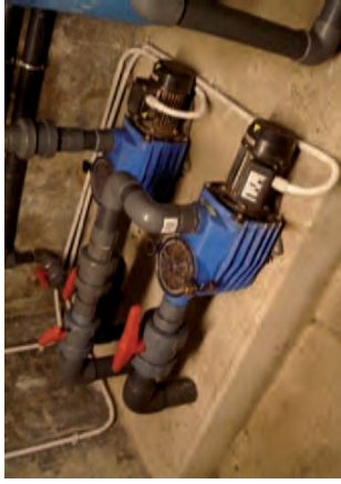
Millora de les instal·lacions de filtracions (equips, control, canonades...).
