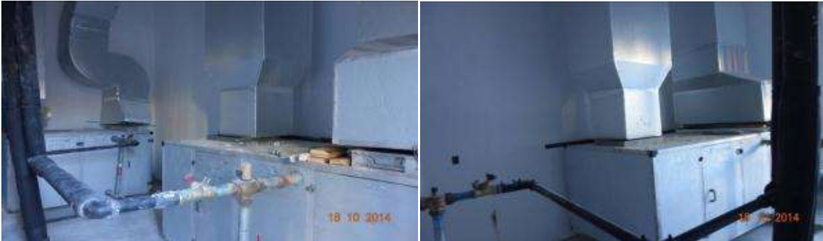
Cuarto técnico del sistema de climatización centralizada, que alimenta la sala de Arquitectura y Urbanismo
