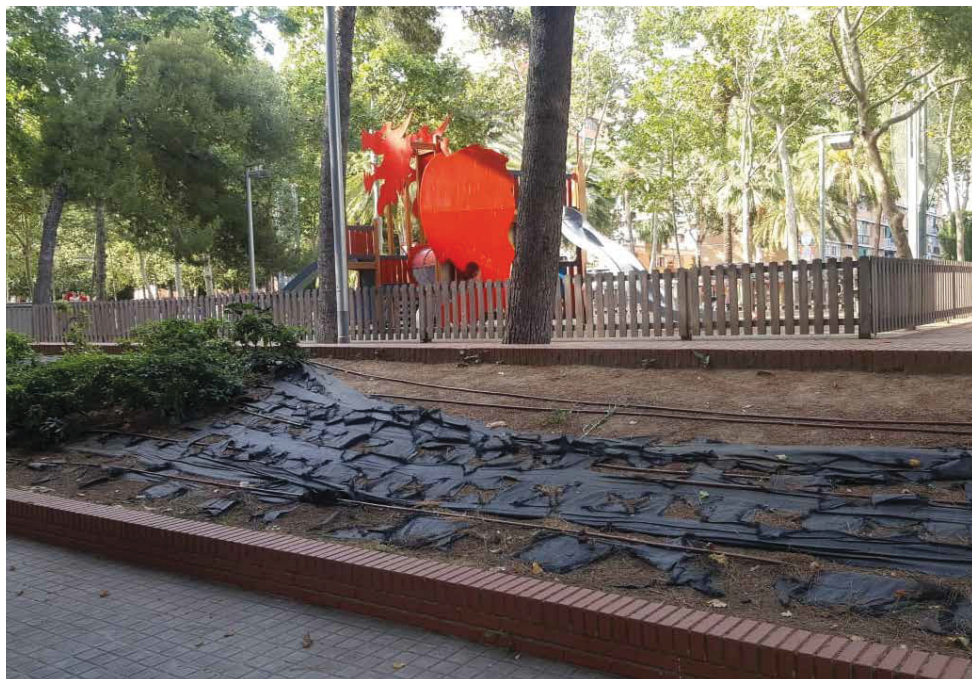
Desnivel ajardinado con falta de mantenimiento.
