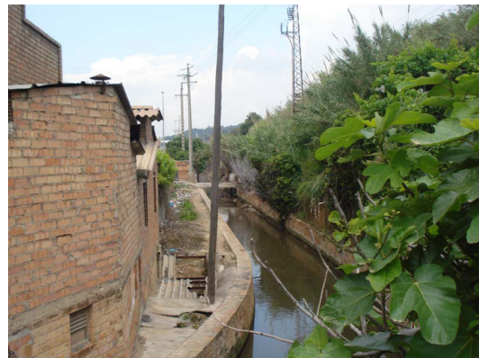
b Canal afectat per soterrament de vies (Font ADIF)
