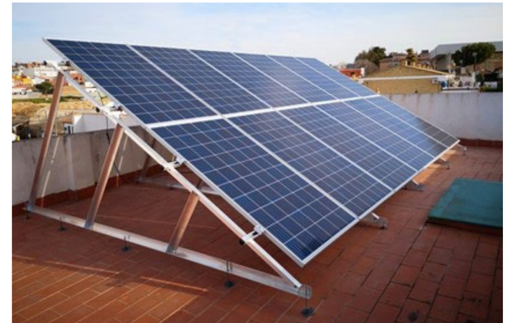
Plaques fotovoltaïques sobres estructura auxiliar conflicte entre fixació mecànica i impermeabilització
