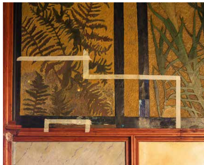
Restoration process of the sgraffiti on the dining room's upper walls Procés de restauració dels esgrafiats de les parts altes dels murs del menjador
