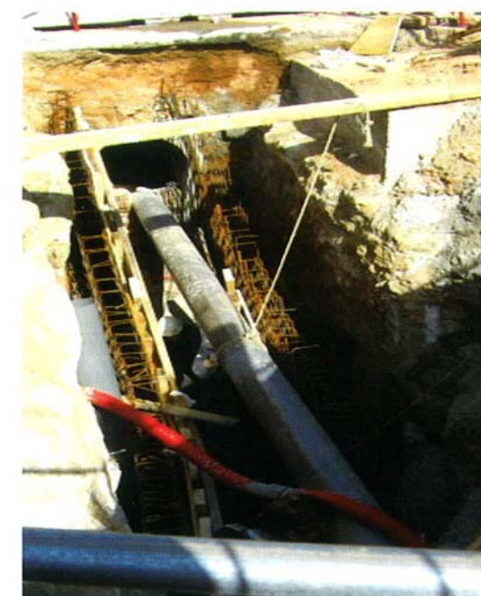
Con el colector más y mejor desagüe y evacuación de las aguas
