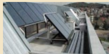
Central tèrmica solar per a l'aigua calenta sanitària (habitatges del carrer Gomis)
