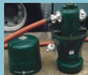
Un dels hidrants on es carreguen els camions cisterna
