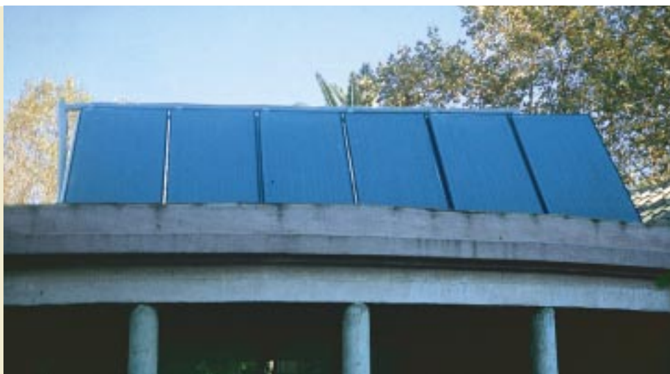
Ubicació dels captadors solars a l'Escola Pau
