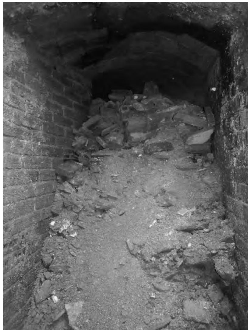
Estat de la galeria del refugi antiaeri omplert de runa.
