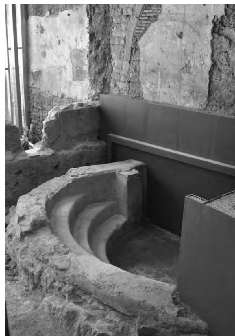
Escales d'una piscina termal durant la fase de restauració. Foto: Servei d'Arqueologia de Barcelona.
