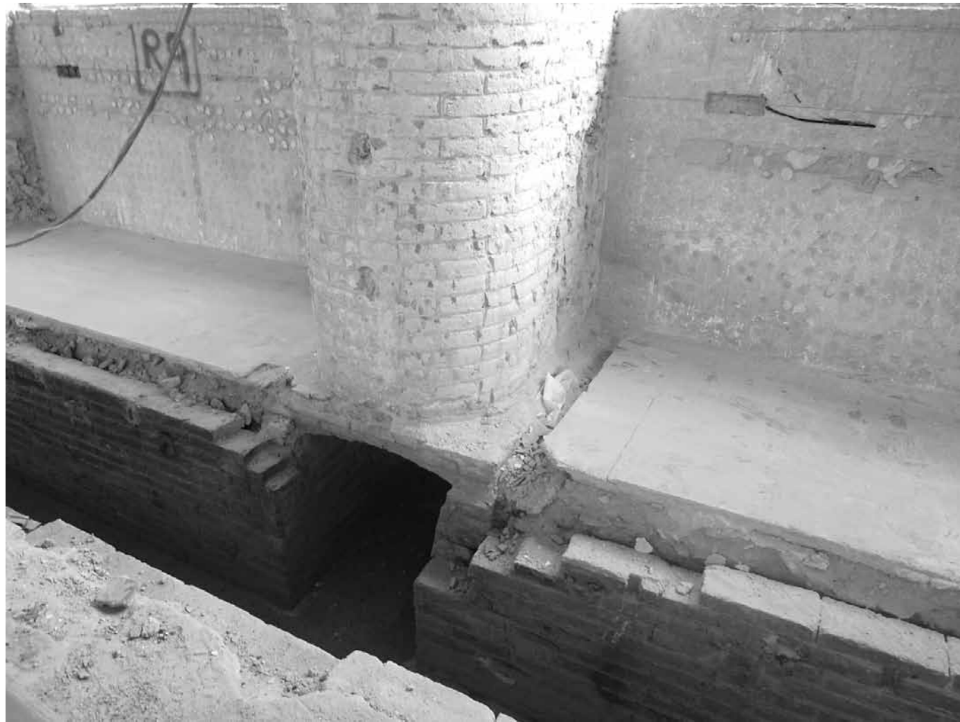
Conducció de calefacció en la intersecció amb un dels pilars del pavelló. Foto: Pere Lluís Artigues.
