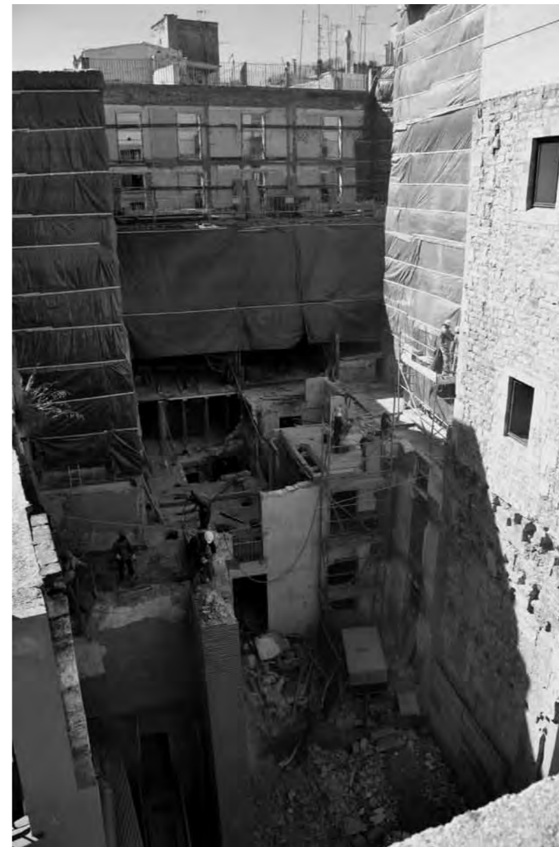
Ampliació del Centre Cívic Pati Llimona, al carrer del Regomir, 7-9. Obres d'enderroc. Foto: Servei d'Arqueologia de Barcelona.
