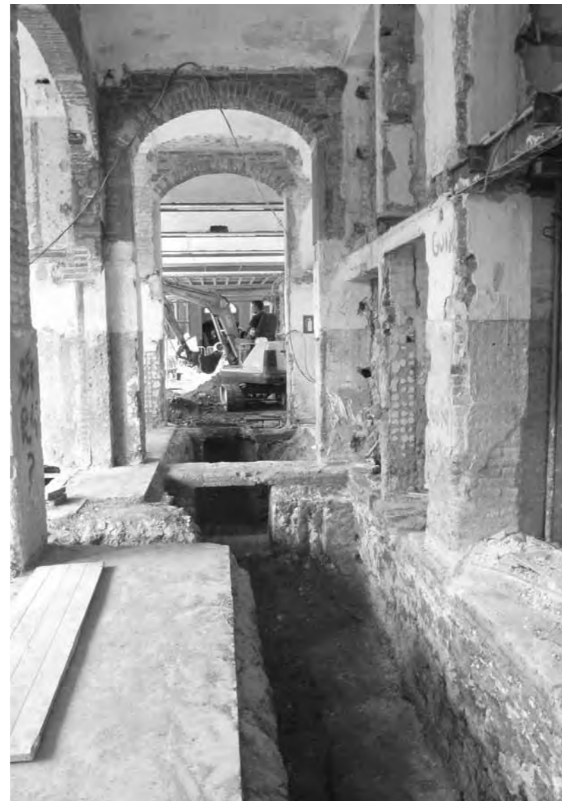
Rasa interior on es veuen les fonamentacions de l'edifici i la solució adoptada per Domènec i Montaner per fer-les més lleugeres. Foto: Pere Lluís Artigues.
