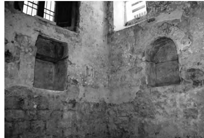
Vista parcial de l'angle més septentrional de la torre. La imatge mostra les dues obertures descobertes (número 1 i 2), que corresponen a les antigues finestres romanes (segle IV) i que foren transformades en petits armariets de la sala medieval –probablement un menjador– vers la fi del segle XII o les primeries del segle XIII.
