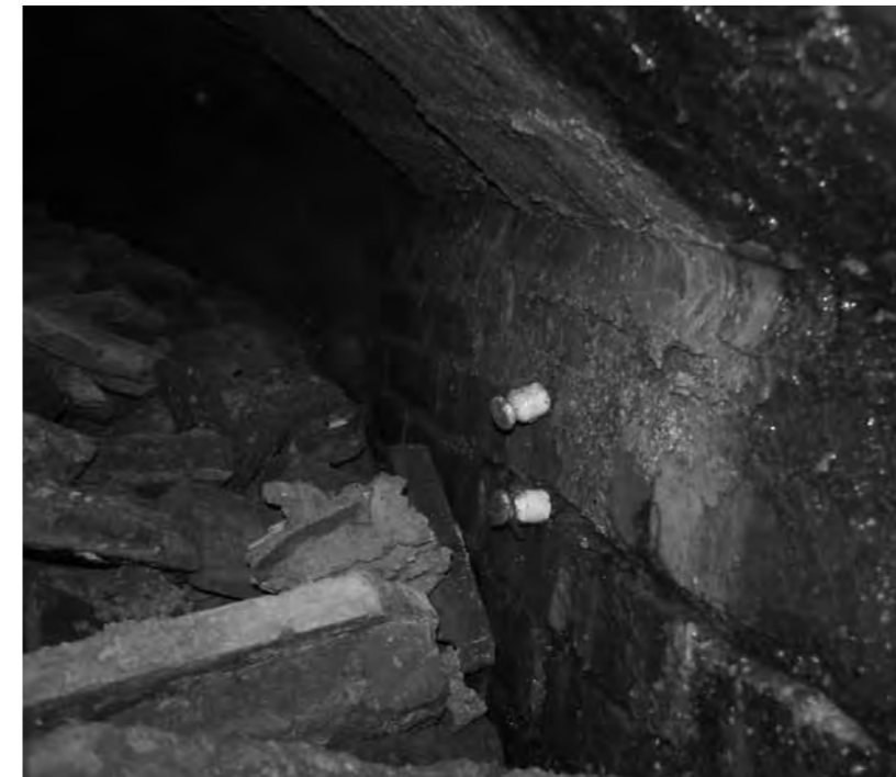
Detall dels aïllants elèctrics de porcellana per a la il·luminació a l'interior.
