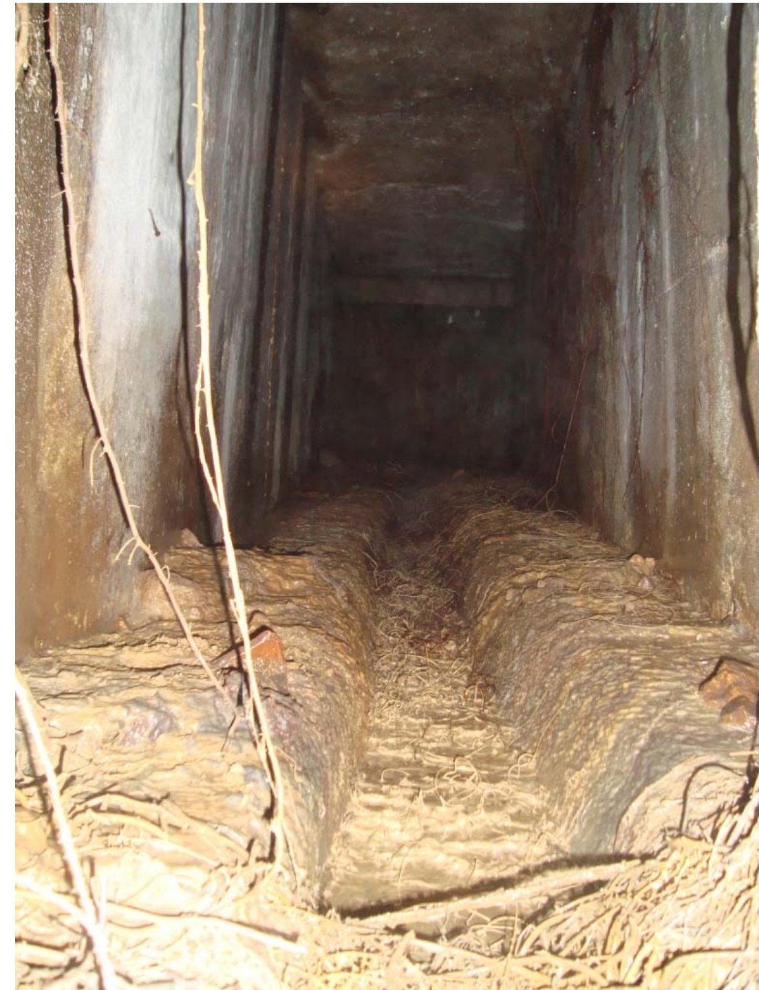
Foto 26. Aspecte de la mina en el primer tram. Tota la solera està plena d'arrels. L'aigua circula per sota.
