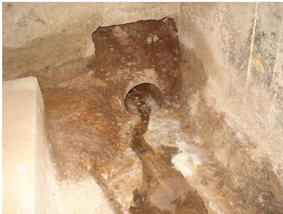
Foto 22. Galeria costat Besòs tallada pel nou edifici. L'aigua que s'infiltra és recollida per un tub.
