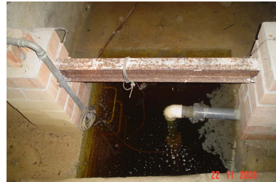
Foto 16. Pou de bombament ple d'aigua. La sala on es troba té la solera totalment seca.
