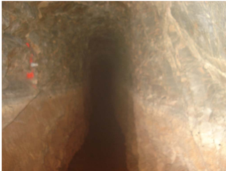
Foto 21. Aspecte de la galeria situada al costat Llobregat. Té humitat però no aigua circulant.
