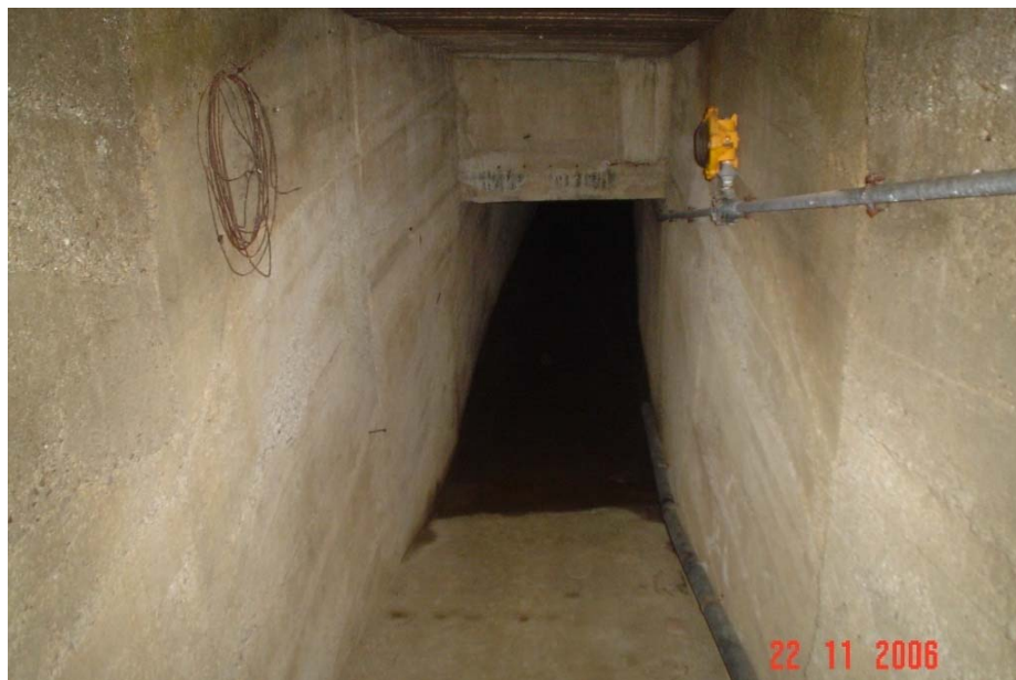
Foto 15. Aspecte de la galeria en el punt on comença a haver acumulació d'aigua.
