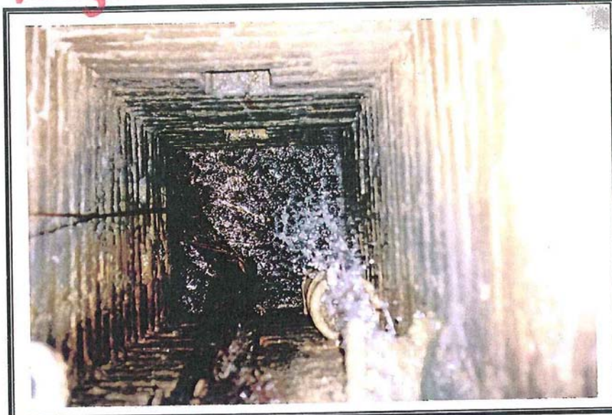
Foto 36 Pozo de caída del agua tras la puerta oxidada. Las raíces llegan desde la mina Vilumara.
