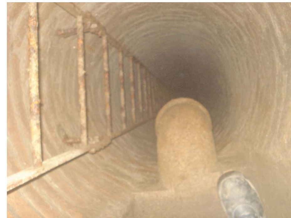
Foto 4. En el salt l'aigua és canalitzada per un tub.
