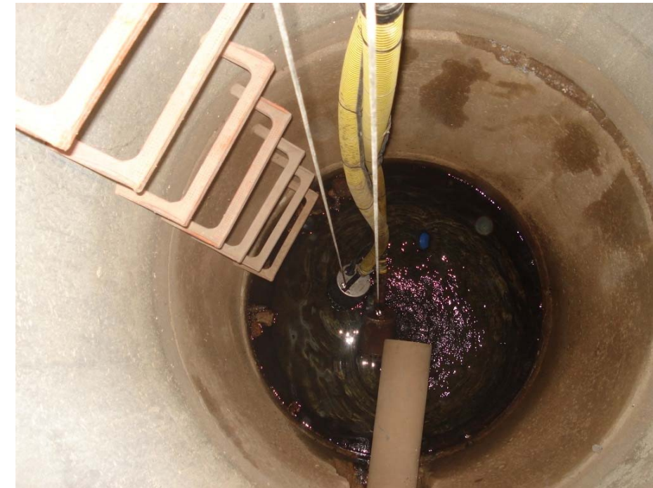
Foto 23. Pou on s'aboca l'aigua recollida pel tub de la fotografia anterior. L'aigua és bombada cap al sistema de desguàs de l'Hospital.
